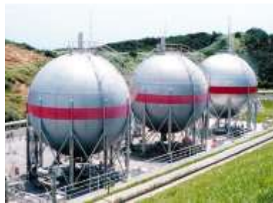
液化水素貯蔵タンク
